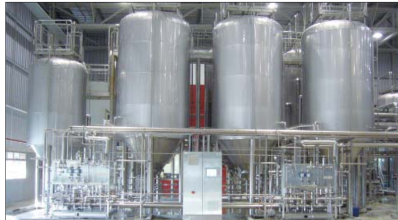
Beispiel einer FLEXI PROP Anlage
